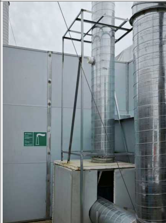
DA002 粉尘废气排放口（远）
