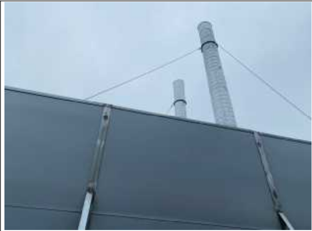
楼顶废气处理排放口
