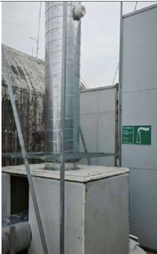
DA001 有机废气排放口（远）
